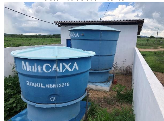
Poço + RAP + Distribuição (tratamento por osmose) em Sítio Canto
