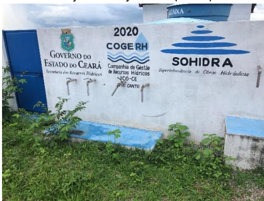
Poço + RAP + Distribuição (tratamento por osmose) em Sítio Canto
