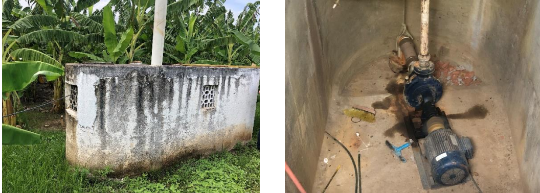
Figura 31 - Captação de Água Bruta - Poço. Fonte: Fundação CETREDE, 2022.
