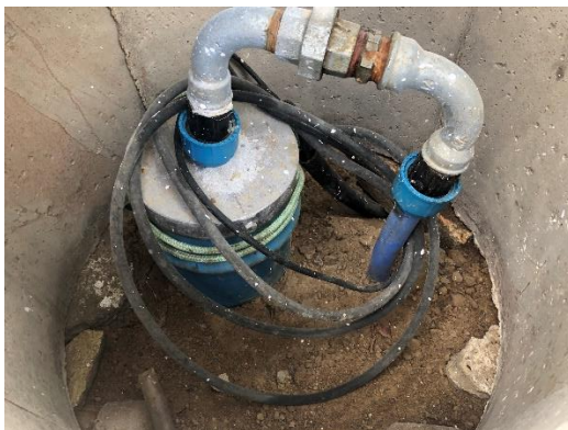
Poço do Conjunto M (SISAR)
